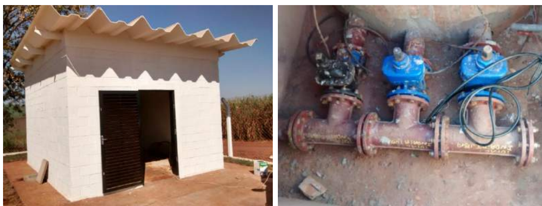
Figura 62 e 63 - Estação elevatória.
