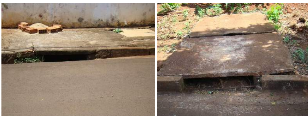
Figura 25 e 26 - Drenagem Existente – Boca de lobo simples.
