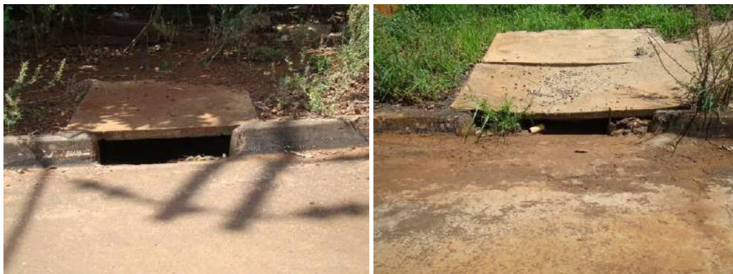
Figura 27 e 28 – Crescimento de gramíneas na entrada do dispositivo de drenagem à direita e boca de lobo simples a esquerda.
