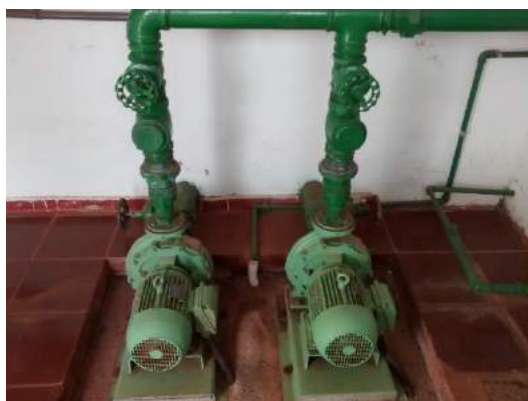
Figura 17 - Conjunto de Motobombas.
