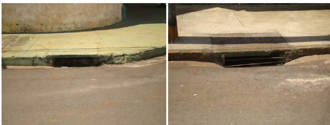
Figura 29 e 30 – Boca de lobo simples em bom funcionamento com gradeamento à direita, contrapondo com a figura à esquerda, que exibe uma boca de lobo simples com abertura muito pequena em relação ao volume de água a ser drenado.
