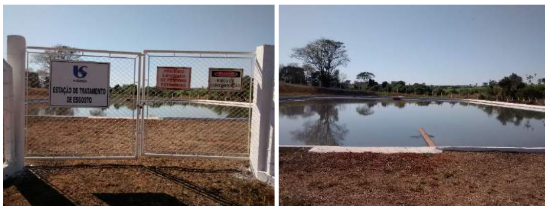
Figura 19 e 20 - Vista Tratamento de Esgoto e Lagoa Facultativa.
