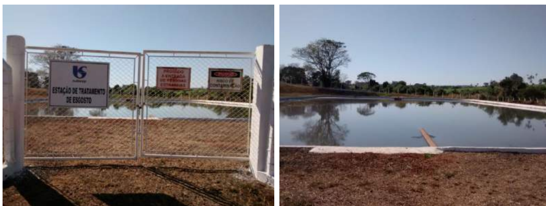
Figura 58 e 59 - Entrada dos Sistema de Tratamento de Esgoto e Lagoa Anaeróbia.
