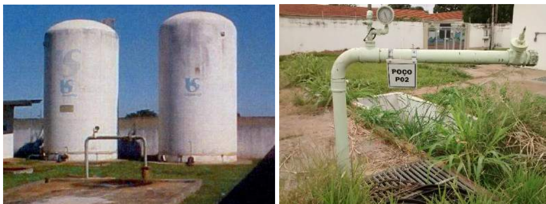
Figura 5 e 6 - Cavalete Poço P01 e Poço P02 (desativado).
