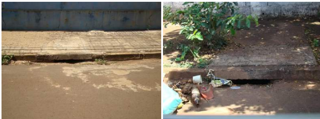
Figura 23 e 24 – Boca de lobo simples apresentando deficiência de escoamento, facilitando o entupimento das mesmas.
