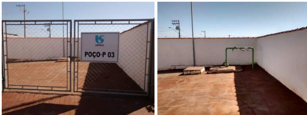
Figura 56 e 57 - Poço de captação de água.
