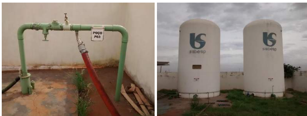
Figura 7 e 8 - Poço P03 e Centro de Reservação e Distribuição de Água Tratada.
