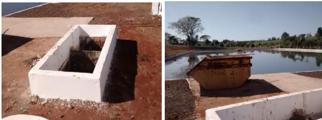
Figura 60 e 61 - Sistema de Tratamento Preliminar (Grade de contenção de sólidos grosseiros) e caçamba para disposição dos resíduos provenientes da limpeza da grade.
