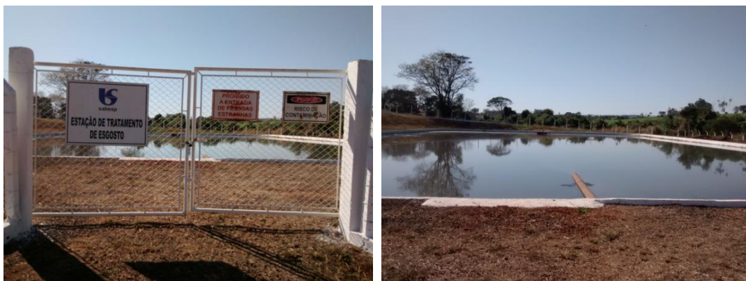
Figura 31 e 32: Entrada dos Sistema de Tratamento de Esgoto e Lagoa Anaeróbia - Fonte: Autor
