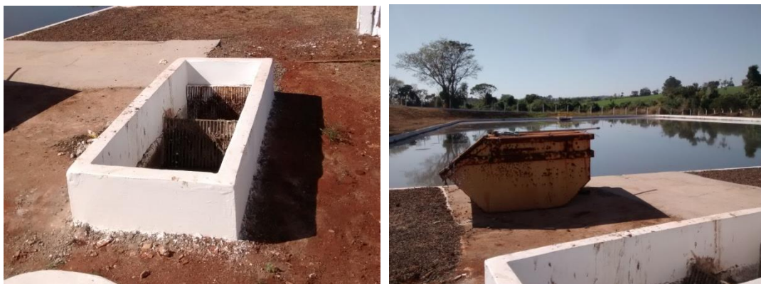
Figura 33 e 34: Sistema de tratamento Preliminar (Grade de contenção de sólidos grosseiros) e caçamba para disposição dos resíduos provenientes da limpeza da grade - Fonte: Autor
