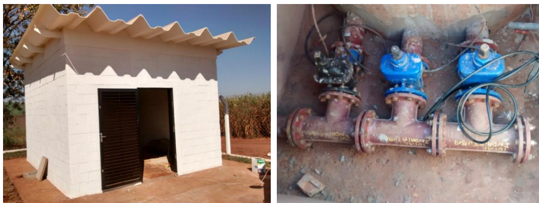
Figura 34 e 35: Estação elevatória - Fonte: Autor
